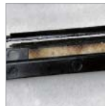
潤滑油乾涸殘留物 下儲油塊破損
